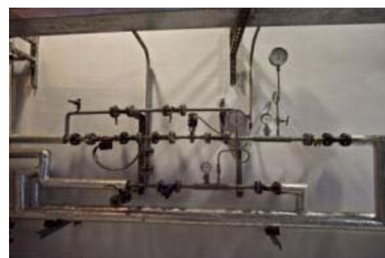
Рис. 27. Техническое оборудование ТЭЦ-26
